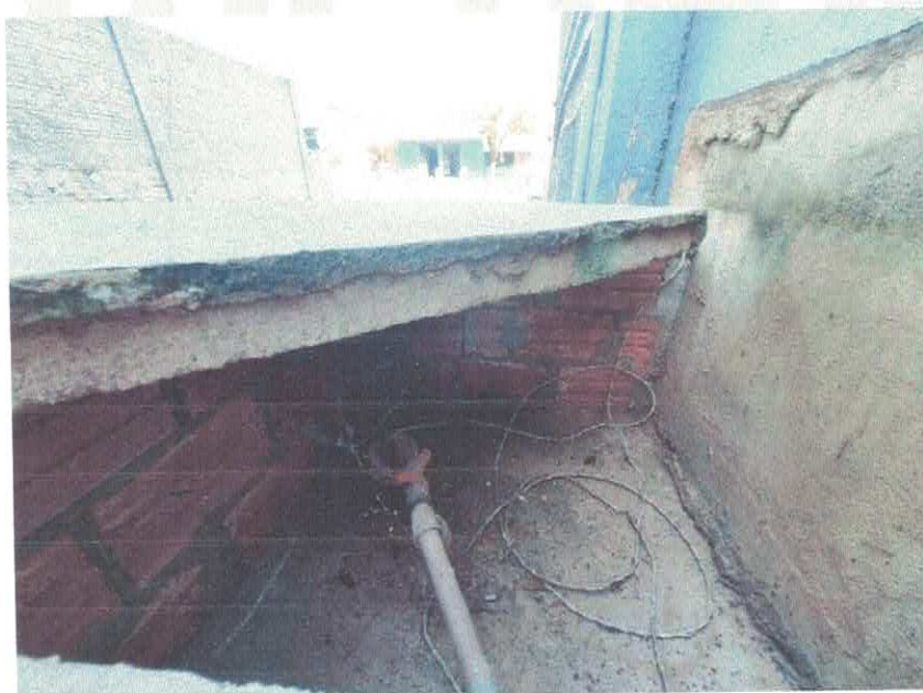
Figura 14: Gabinete Poço Artesiano.
