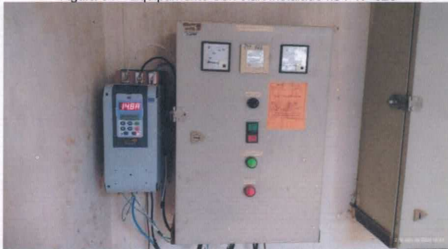
Figura 04 – Equipamento Soft start instalado no PTP 026
